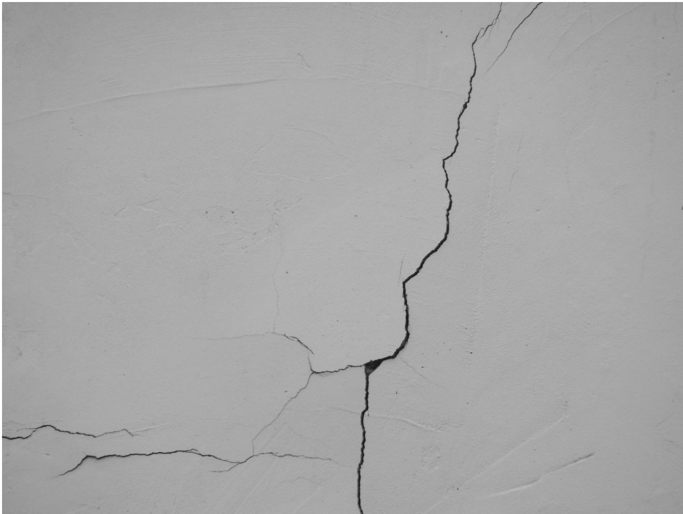
Foto 3 von 6 · Küche / Wand: Riss im Putz neben dem Fenster, ca. 60 cm lang.
